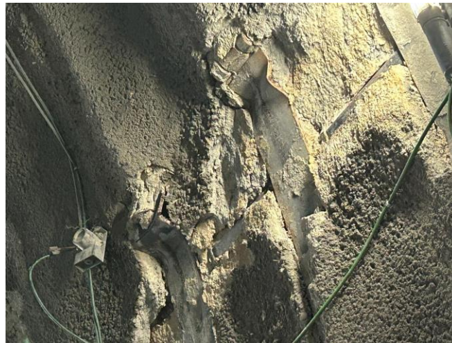
Fig 1. Rottura della centina per carico di punta (buckling) nel cantiere del COCIV (visita tecnica 2022)
