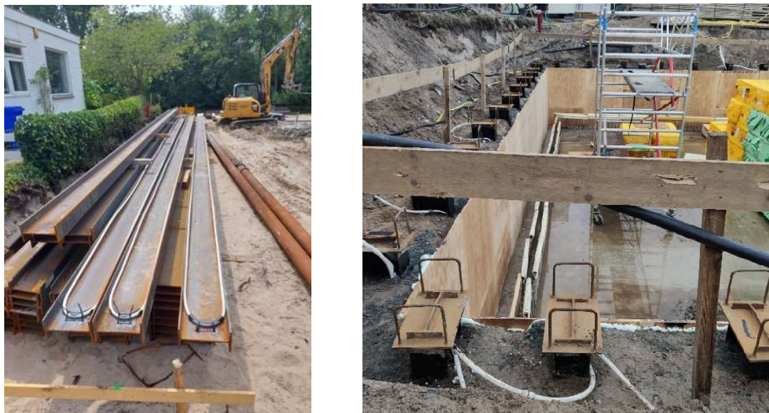
Fig 1. Dettagli del campo prova: a) tubi scambiatori di calore attaccati sui profili di acciaio IPE b) campo prova del diaframma CSM termo-attivo
